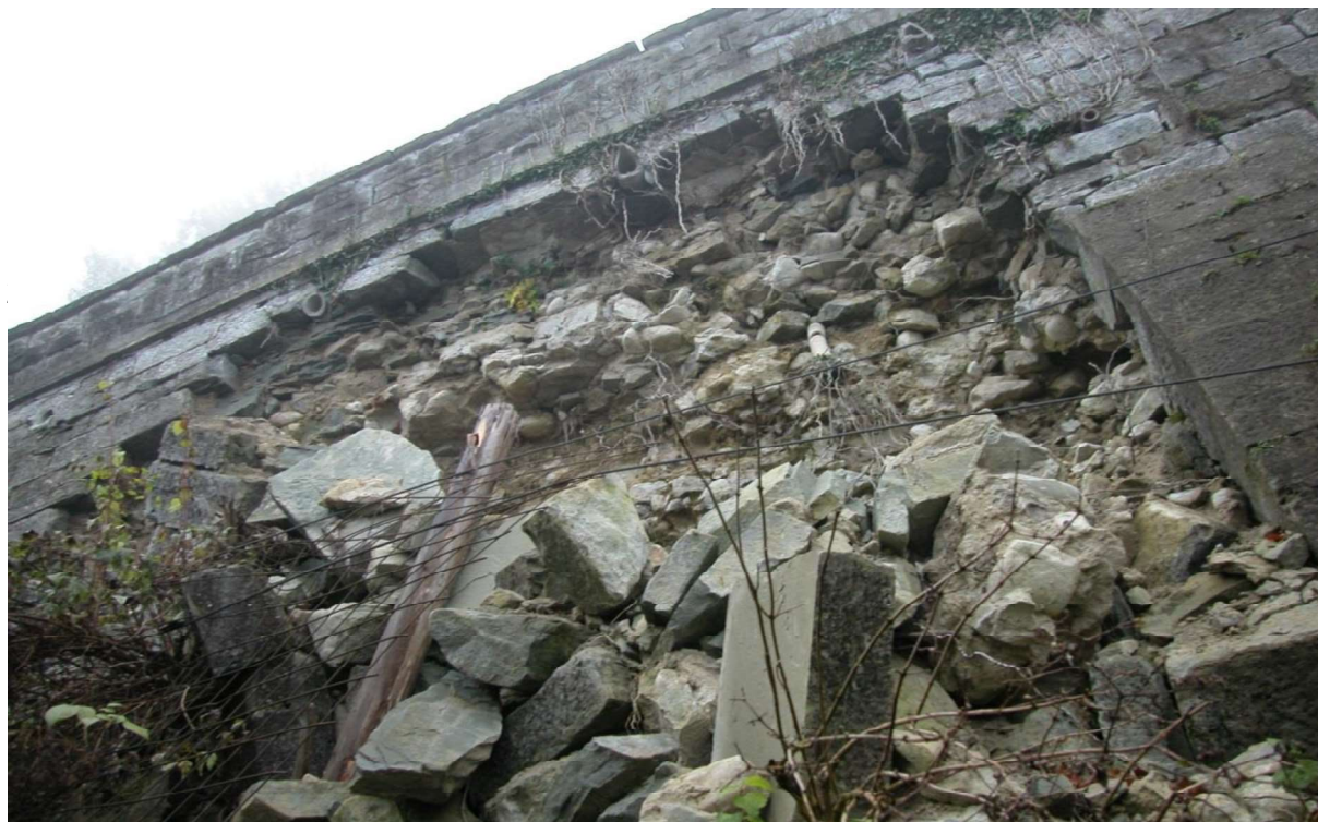
2005: Die Terrasse nach dem ersten Einsturz: Die Sandsteinverkleidung wurde um das ältere Mauerwerk herum gebaut, die Stahlseile stammen von einer dilettantischen Sicherung aus den 1990er Jahren.
